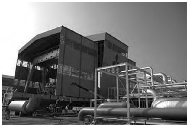
図1 大型試運転設備（外観）
