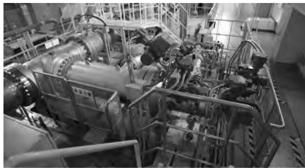
図8 高温配管予熱装置
