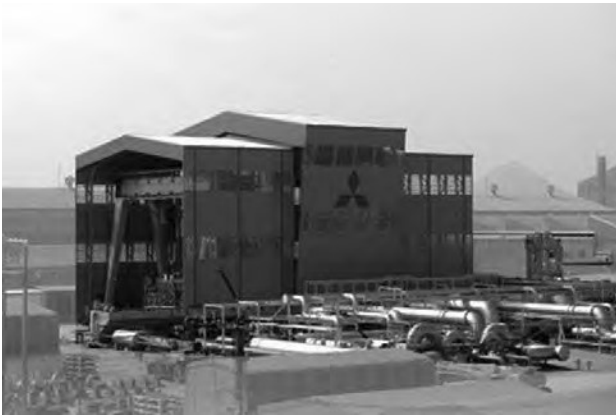
図3 大型試運転設備（ガス配管）
