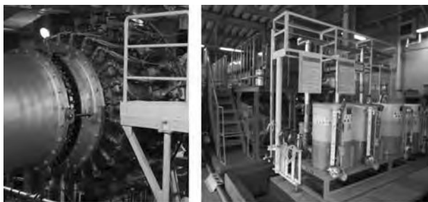
図15 排気冷却器と排水処理装置
