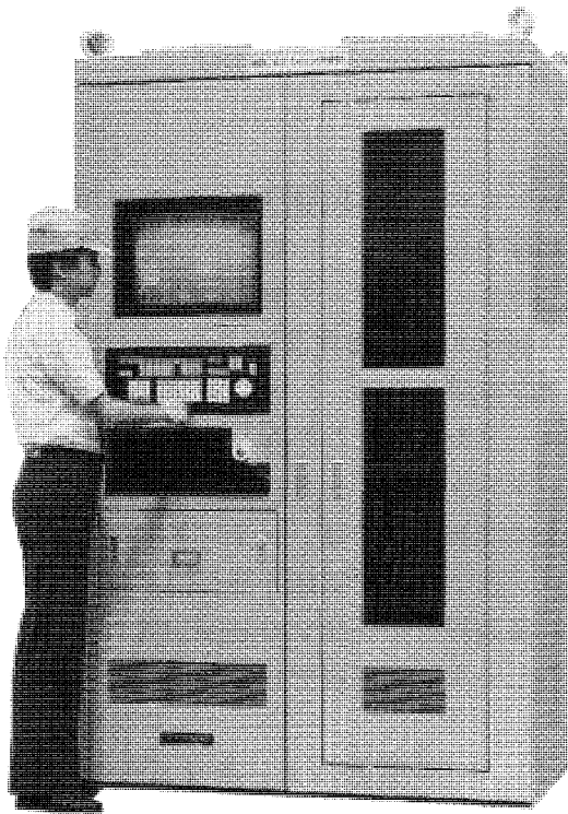
図5 ガスタービン制御装置
