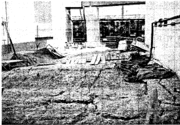
図6 配管ピット陥没
