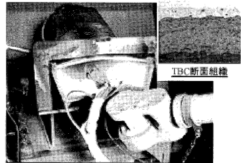
図13 燃焼器トランジションピースへのロボット TBC 施工風景
