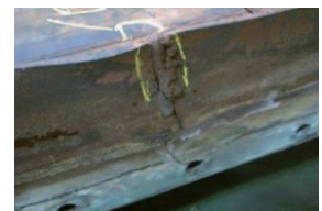
フランジボルト穴の貫通き裂
