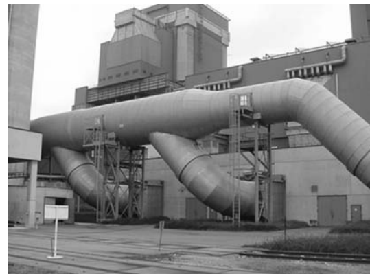
Fig. 6 Duernrohr発電所の脱硝装置の位置
