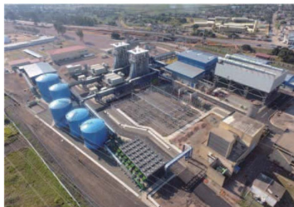
Fig. 4 発電設備全景
