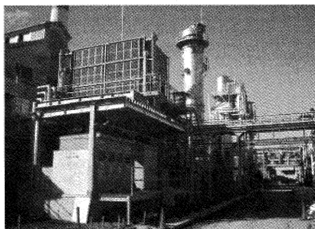
図11 バイパススタックおよび排気スタック （ガスタービン前側より見る）
