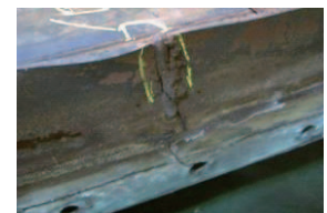
フランジボルト穴の貫通き裂
